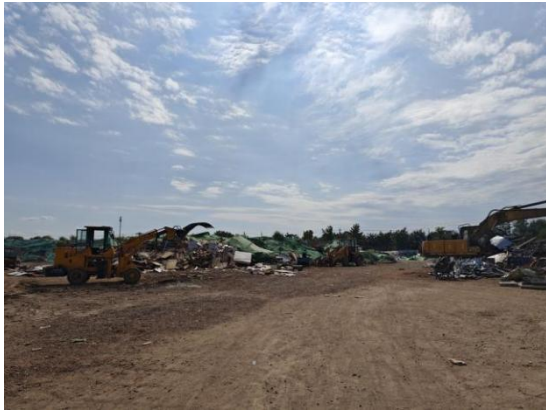
照片 2-9 西冉片区-堆放建筑垃圾
